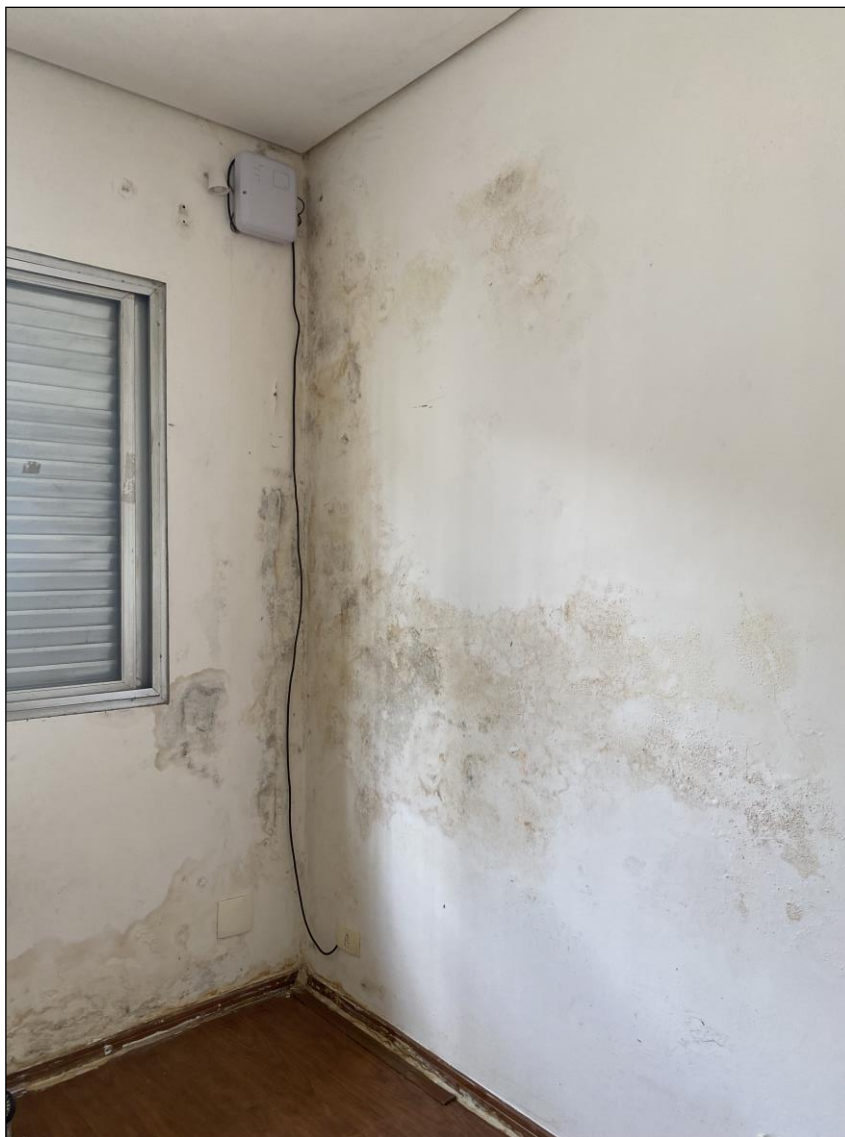
FOTO 27 – MANCHAS PAREDES DIVISA GEMINADA.
