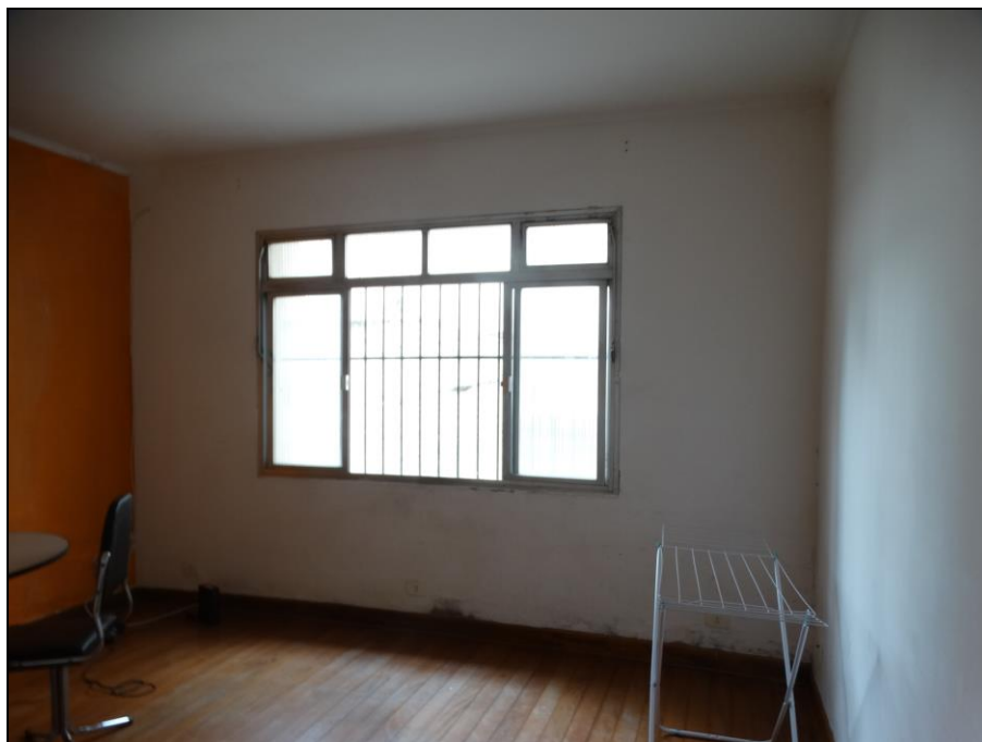
FOTO 31 – ASPECTO DO PISO COM DESGATE.
