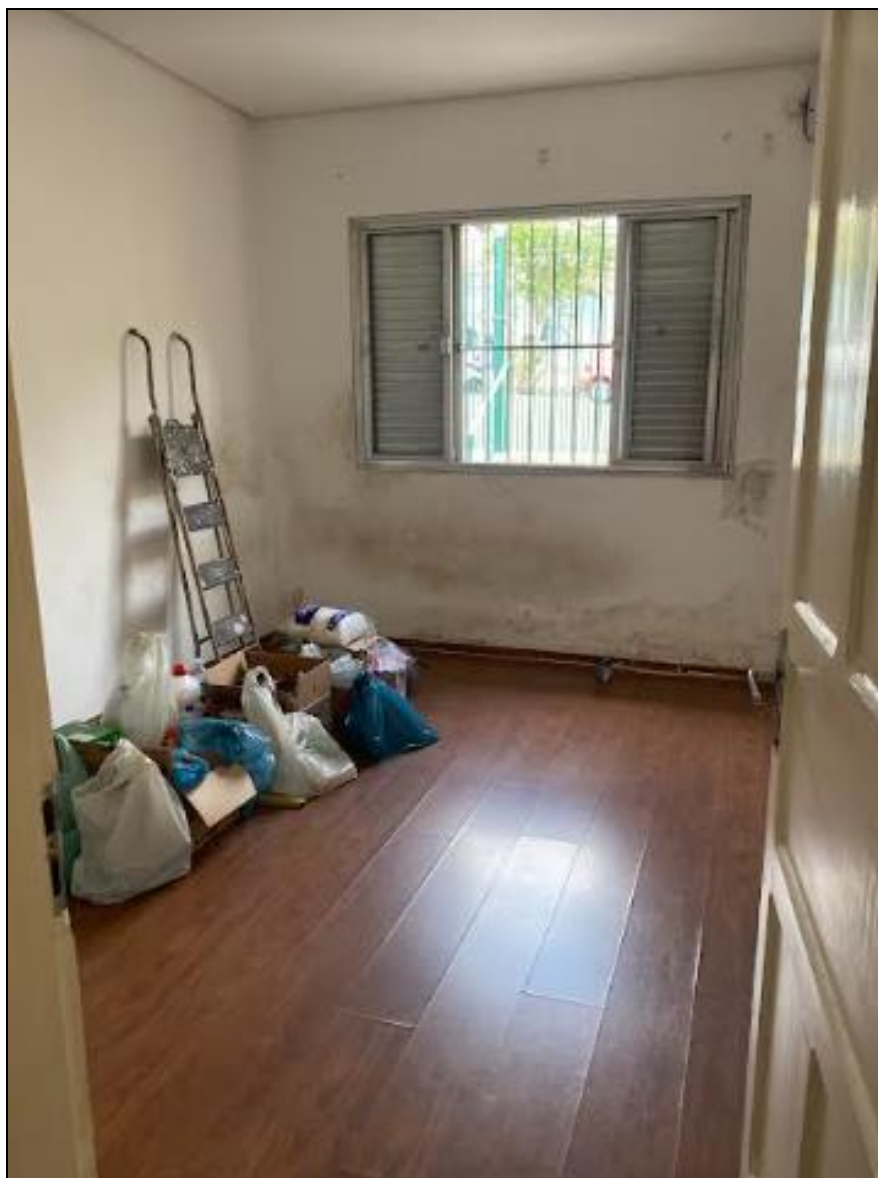
FOTO 26 – MANCHAS PAREDE FRONTAL..
