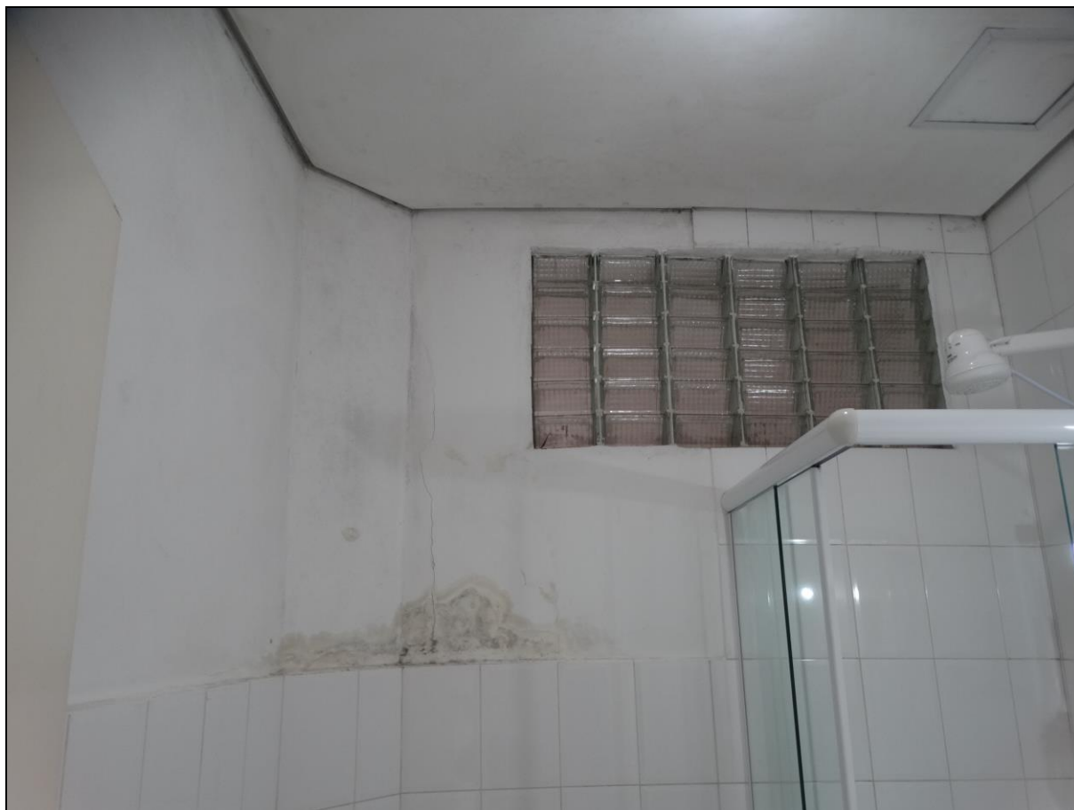
FOTO 36 – FOCOS DE INFILTRAÇÕES.
